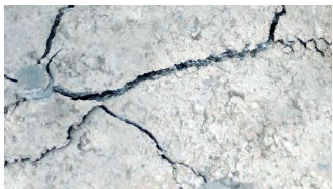
Spalten durch Quelldruck
